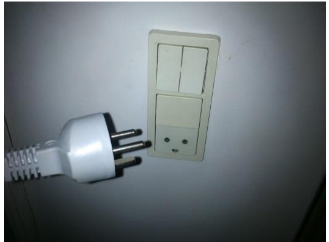
Branchement du CT-scanner sur une prise électrique standard. Pas d'installation électrique spécifique.
